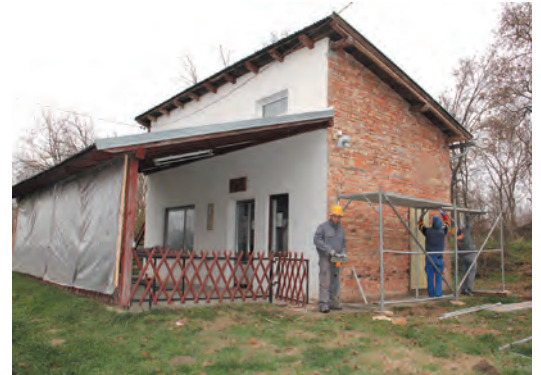
I na domu UŠR-a Virje u Gat u započeli su radovi na energetska obnova objekta
